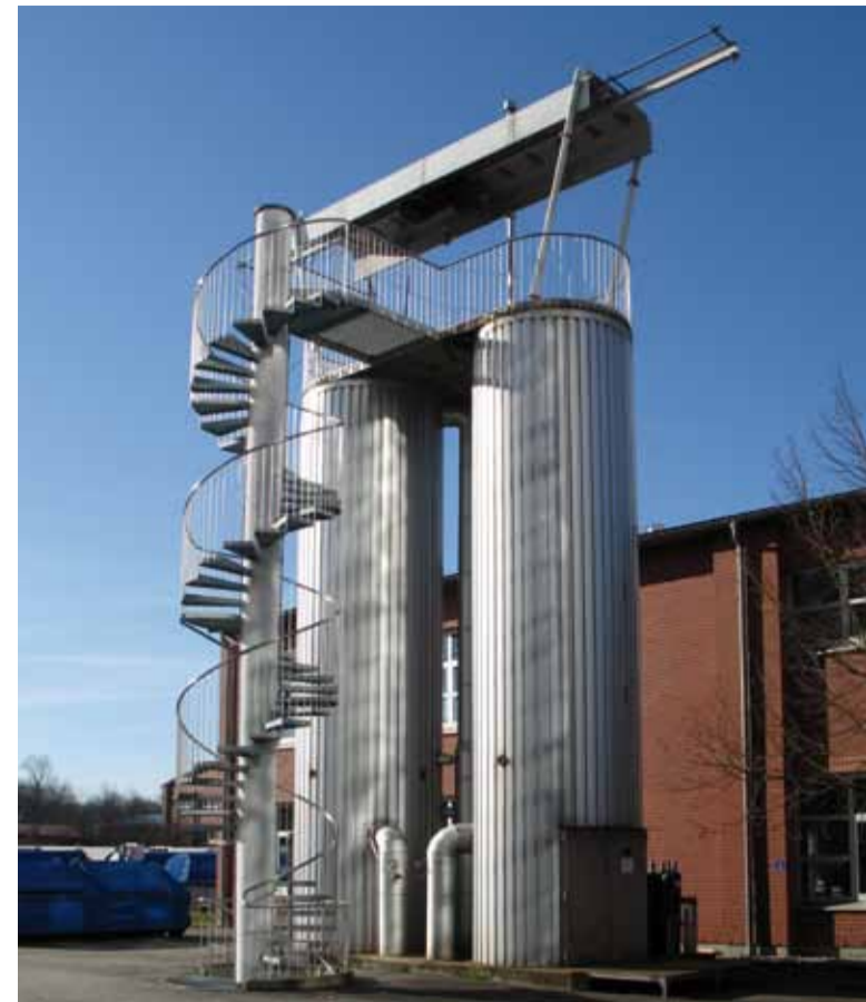
Faulgasreinigung in Entschwefelkolonnen
