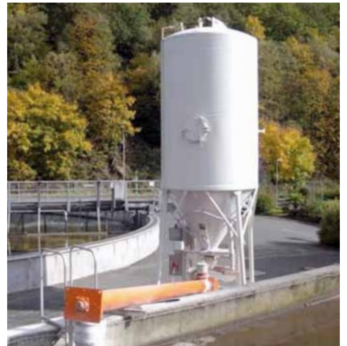
Kreidezugabe auf einer Kläranlage, trocken
