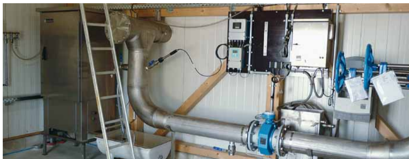
Abb 4b: Einbausituation S:CAN-Sonde zur Ablaufüberwachung
