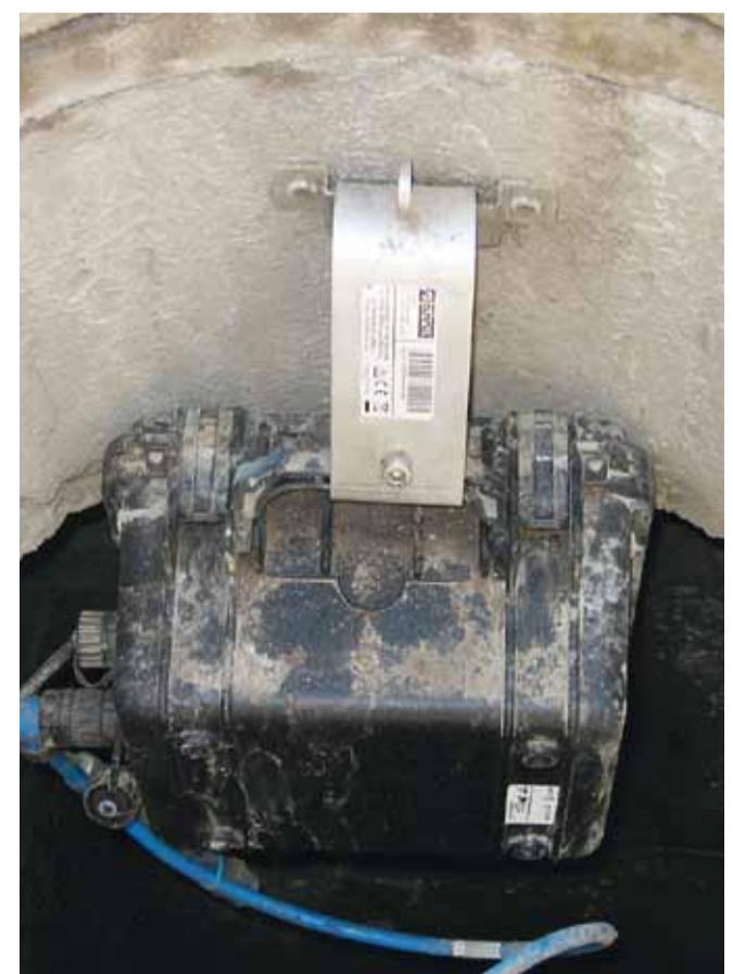
Gerät nach wenigen Tagen Einsatz
