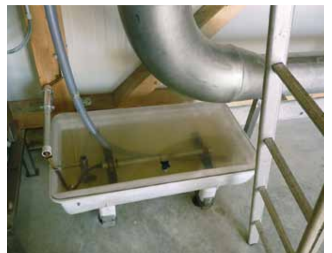
Abb 4a: Einbausituation S:CAN-Sonde zur Ablaufüberwachung
