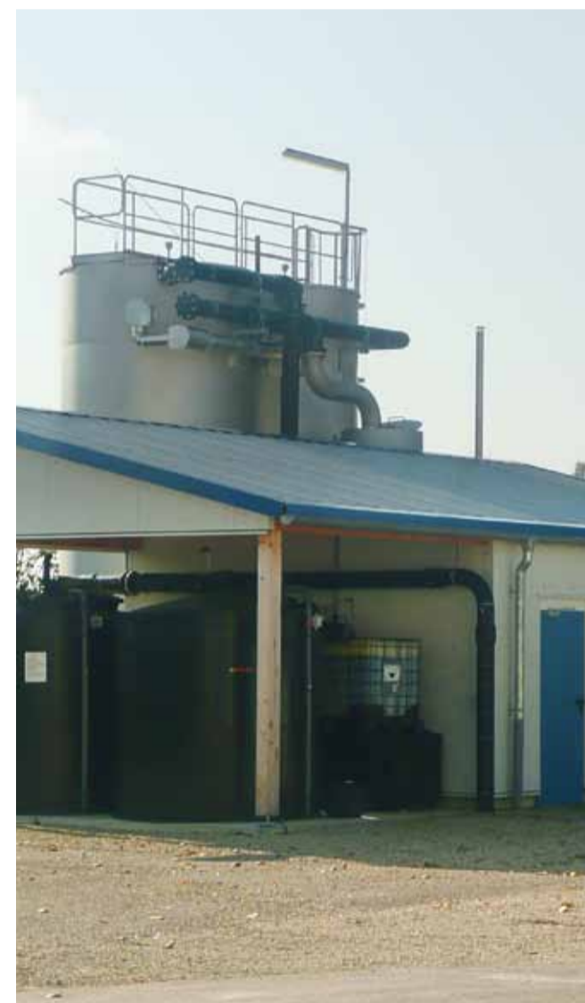
Abb 5: Nachgeschaltete, kontinuierlich gespülte Sandfilterstufe (System „Nordic-Water“)
