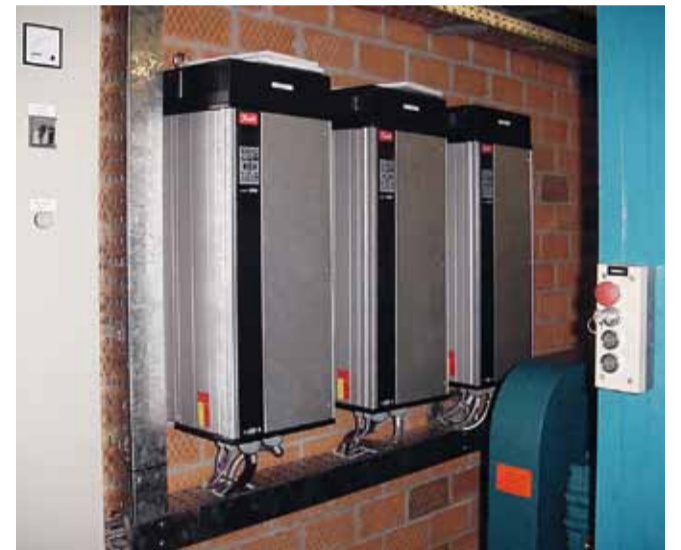
Frequenzumformer im Einsatz
