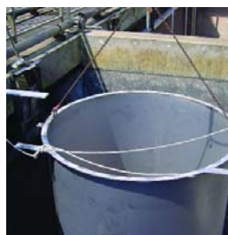
Technische Speziallösungen für Kläranlagen (Selektor KA Zellertal)
