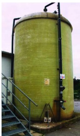
Bis heute in Betrieb: die erste Dosieranlage von 1989
