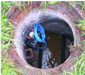
1 PCM Pro im Schacht montiert
