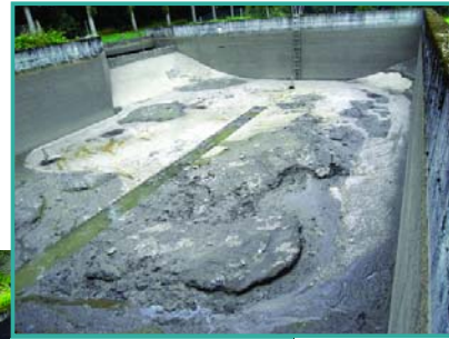
Stark verschmutztes Regenüberlaufbecken im Nebenschluss
