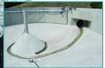
Rundbecken mit fest installiertem Rührwerk
