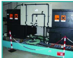
Anlage zur Reinigung von Belüfterkerzen
