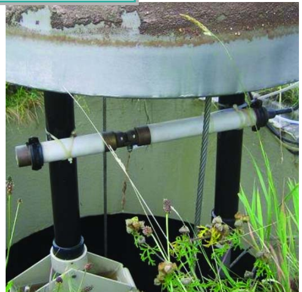
Abbildung 6: Einbausituation der Sonde, Schwimmerinsel für Qualitätsmessungen
