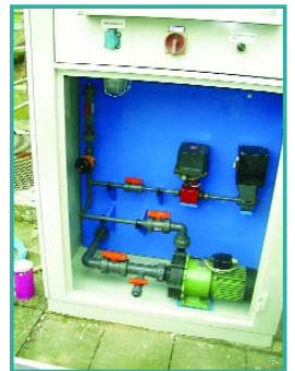
4 Neue Verrohrung und Neuausrüstungen wie Durchflussmesser, Pumpen, Regelventil
