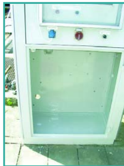
2 Der "Nastteil" des Dosierschranks wird innen komplett gereinigt und bei Bedarf neu lackiert.
