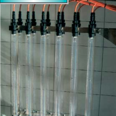
Anlagentechnik und Messtechnik
